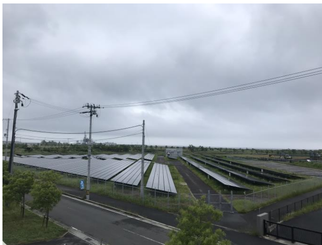
▲淡路市役所に隣接するメガソーラー発電設備。傾斜角度10°で設置。
