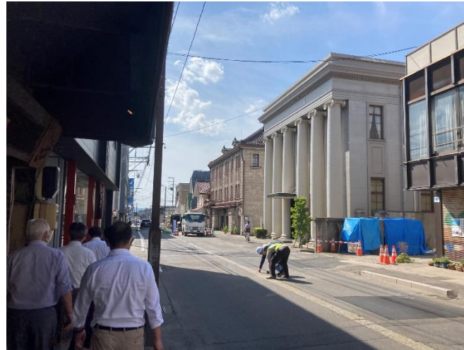
▲元銀行等の古建築を再生し、活用へと工事をしている現況
