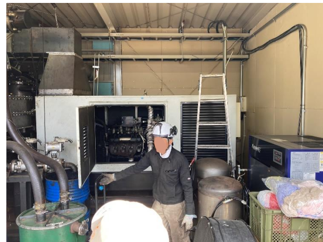
▲発電機の心臓部：800℃のガス でエンジンを稼働して発電する
